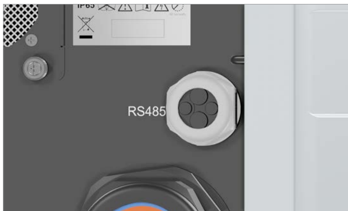
Abb. 4.14: Kabeldurchführung für die Kommunikationskabel
