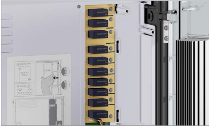
Abb. 4.13: Ansicht der DC-Überspannungsableiter bei entfernter Abdeckung
