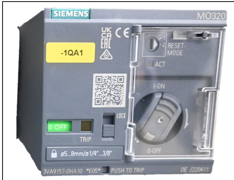
Abb. 13 Leistungsschalter 1QA1 im ControlShield rechts vorn
