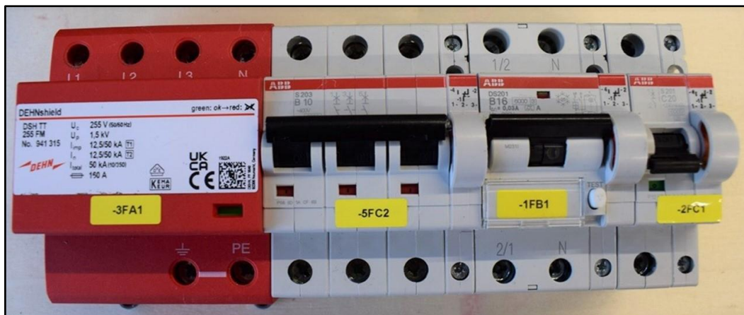
Abb. 14 Blitzschutz und Leitungsschutzschalter im ControlShield hinten Mitte
